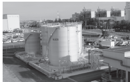
サンラックスが新設したケミカルタンク
